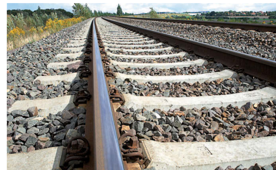
ゆがみがないレール Rails without buckles
